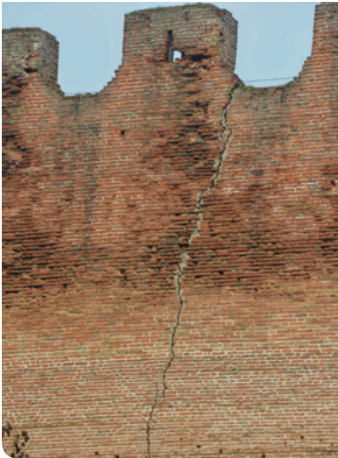
Parete Ovest. Le crepe verticali, a tutto spessore
