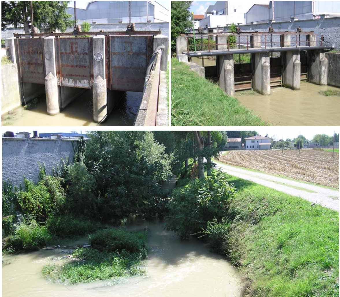
Figura 4. In alto le paratoie Barban: a sinistra le paratoie che regolano l'immissione nell'Avenale, a destra quelle che controllano la roggia Brentanella. In basso la roggia Brentanella vista da monte.
