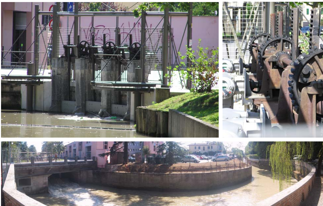
Figura 3. Paratoie delle Fosse (in alto, particolare) e scarico del torrente Avenale (in basso).
